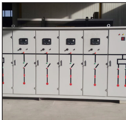
Synchronize & ATS Panel
